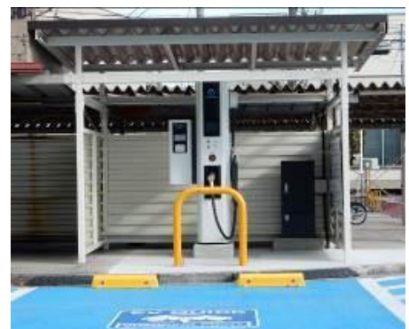
電気自動車急速充電器
