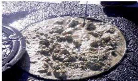
越流した油脂で下水道本管が閉塞し、下水が溢れたマンホール
