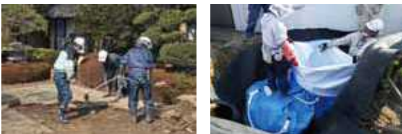
池ノ台地区の住宅のモデル除染を実施し、効果的・効率的な除染方法を確立して、一般住宅の除染を進めます。
