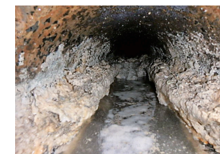
油により閉そくした下水道管
