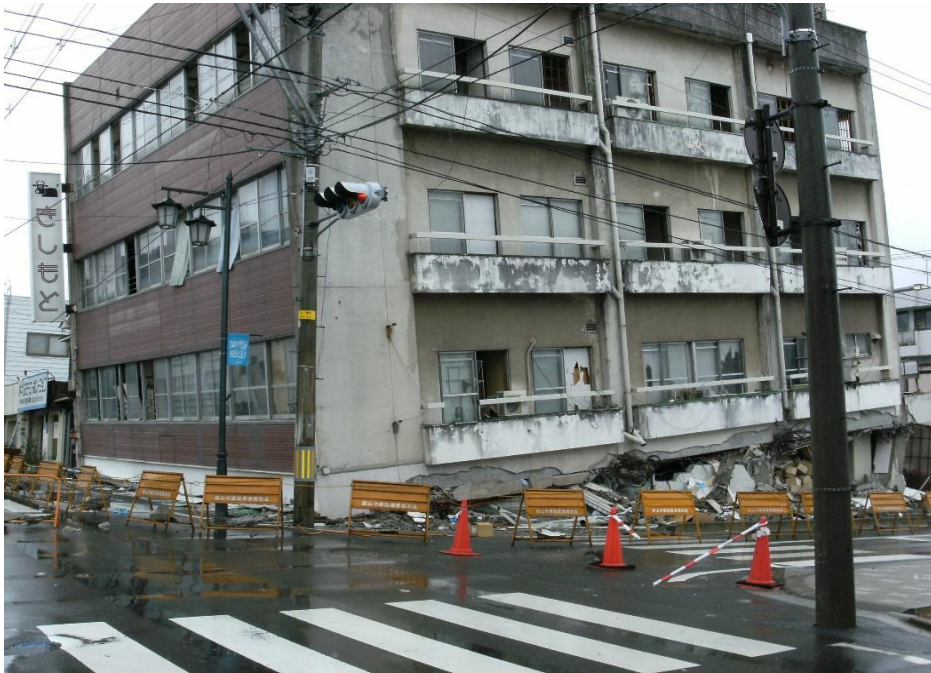
東日本大震災により1階部分が潰れてしまった市内のビル
