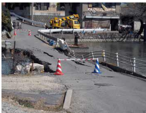
▲市内各所で道路陥没
