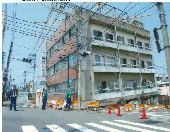
▲1階部分がつぶれたビル
