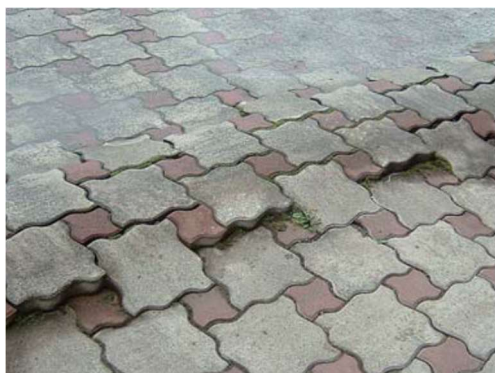
A 3-2 ブロック舗装の隆起
