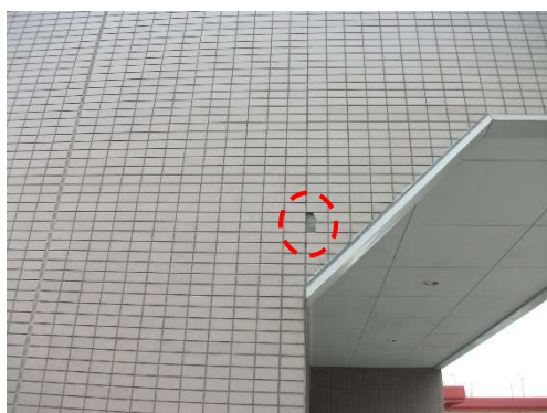
C 2-1 外壁タイルの剥がれ、破損
