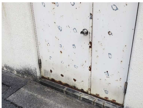
D 2-3 金属製扉の腐食
