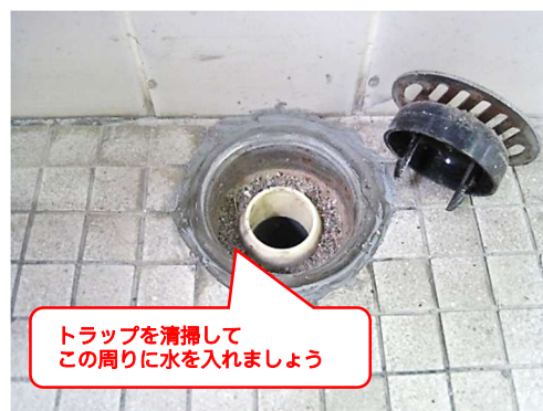
F 1-2 トイレ床排水口からの異臭
