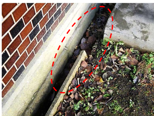
A 4-1 側溝の落葉による排水不良
