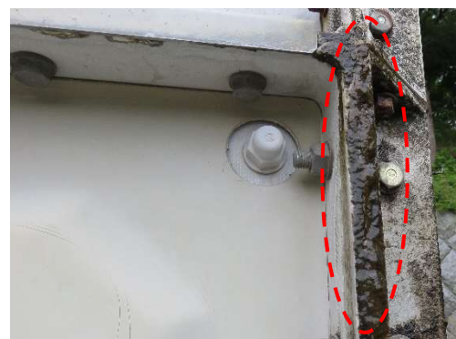
F 5-2 受水槽からの水漏れの疑い
