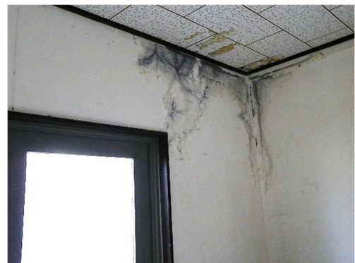
E 4-2 雨漏りによる壁面のシミ
