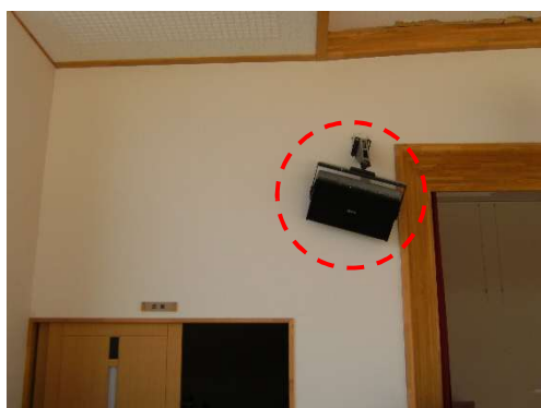
E 6-1 壁面スピーカの脱落
