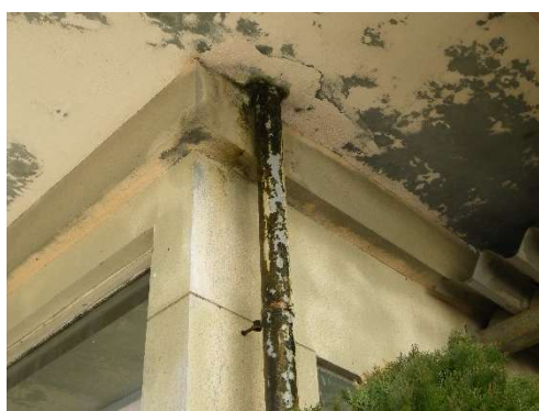
C 5-1 雨樋の腐食
