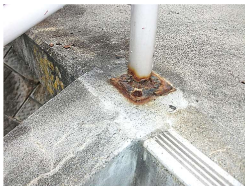
A 5-3 階段手すりの脚の腐食
