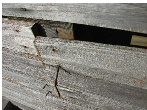
A 2-2 木製柵の破損、くぎの突出
