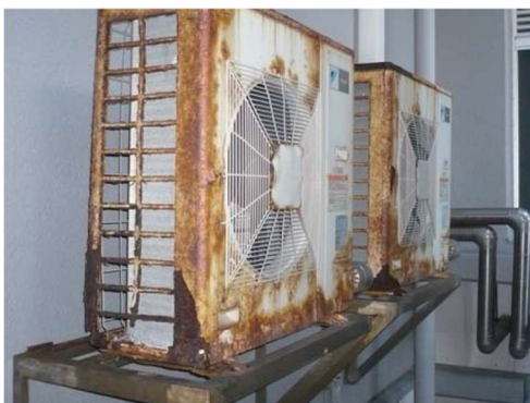
H 3 エアコン室外機の腐食
