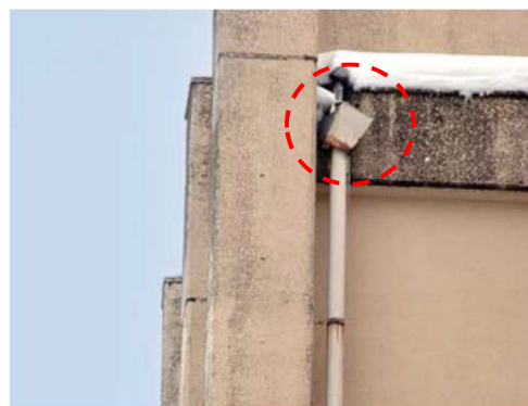
C 5-2 雨樋落下の危険
