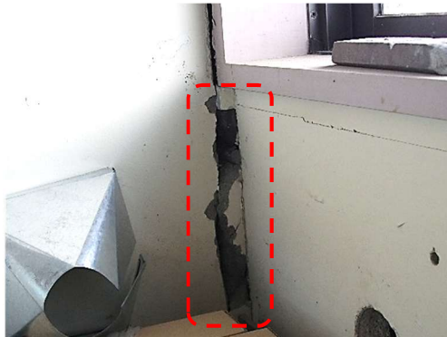
E 2-3 壁のひび割れ、破損
