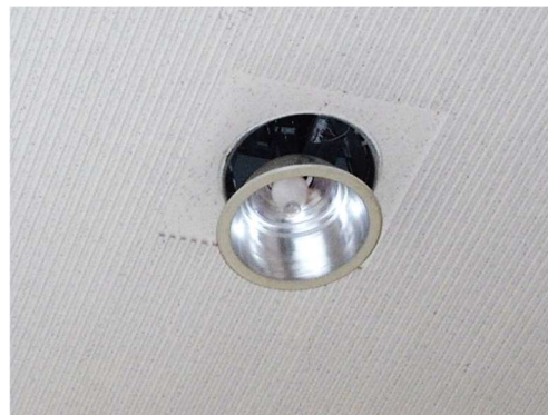
I 1-2 ダウンライトの落下の危険
