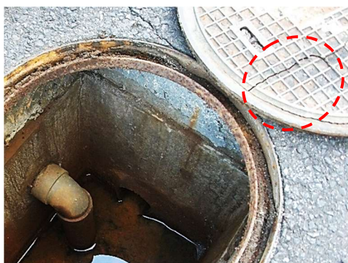
A 4-3 排水柵のふたの割れ
