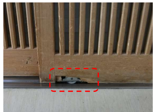
D 2-2 引戸の破損
