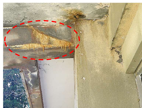
C 3-6 コンクリートの錆汁、白華
