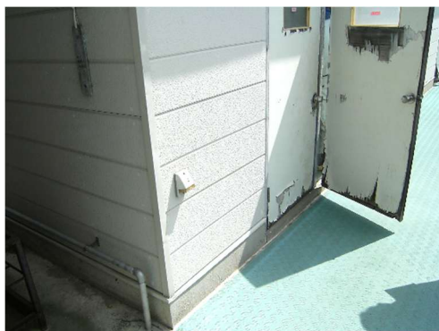
D 2-1 木製扉の腐食
