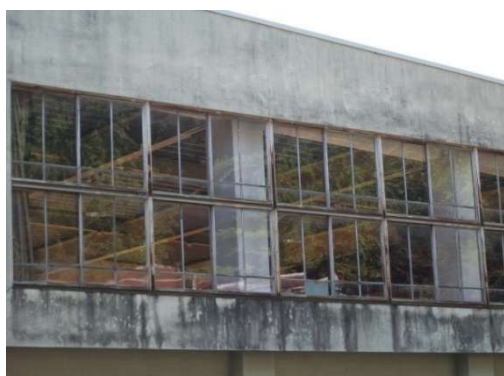
C 1-1 外壁塗装の劣化
