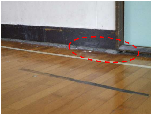
E 1-1 床の沈下
