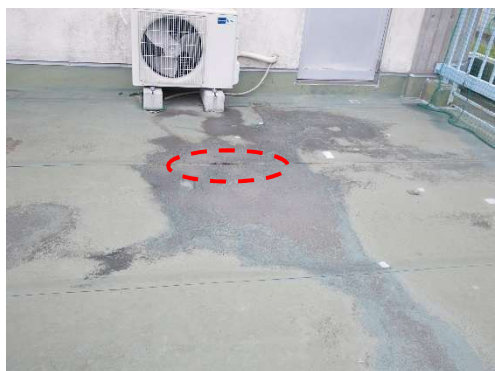
B 1-3 屋上防水シートの剥がれ、劣化
