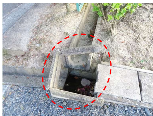
A 4-2 排水柵の破損
