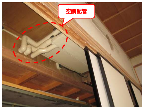
H 4 空調配管の水漏れの確認
