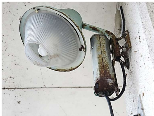
I 1-1 外灯の腐食
