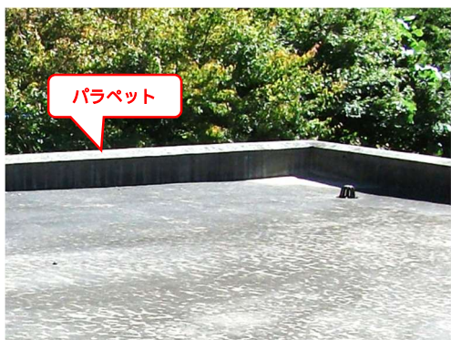
B 2-1 パラペットのひび割れ、浮き、破損の確認
