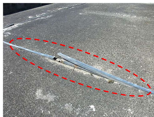
B 1-2 左写真点線部アップ (目地の劣化、剥がれ)
