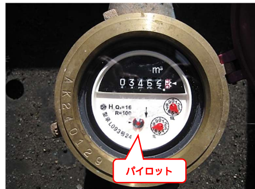
F 4 水道使用量の異常増加の確認
