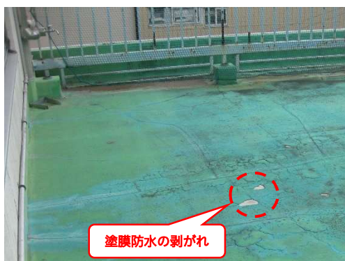
B 1-5 塗膜防水の剥がれ、劣化
