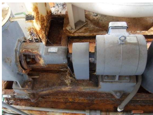
F 6 ポンプの腐食
