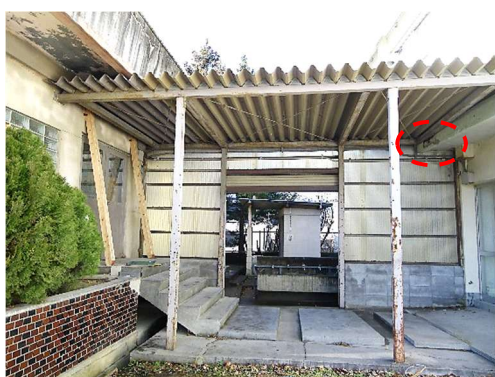
C 3-1 軒コンクリートの 破損(爆裂)、鉄筋の露出
