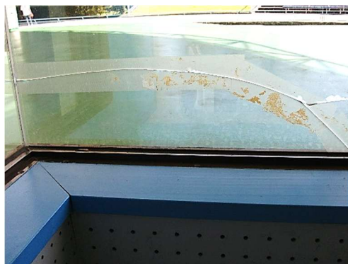
D 2-4 ガラスのひび割れ
