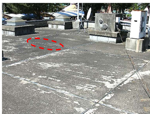
B 1-1 屋上コンクリート防水の劣化
