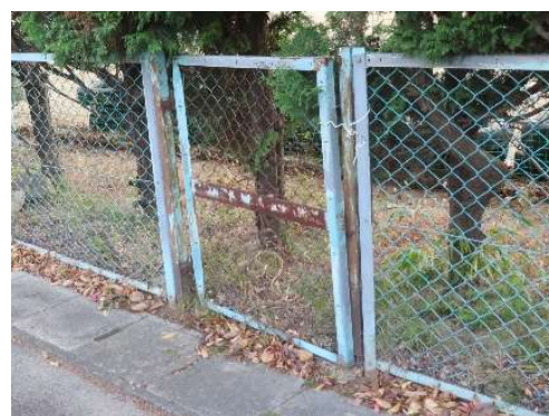
A 2-1 フェンスの腐食、破損
