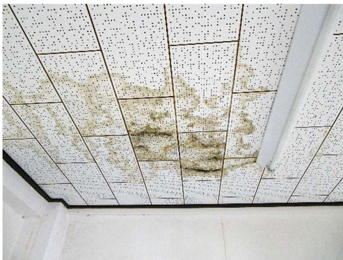
E 4-1 雨漏りによる天井面のシミ
