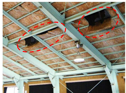
E 3 体育館の天井断熱材の剥がれ
