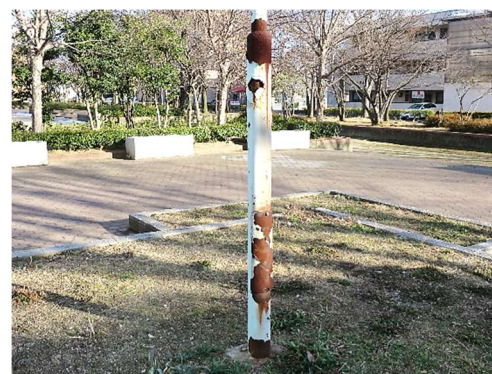
A 5-1 外灯ポールの腐食
