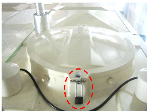
F 5-1 受水槽点検口の施錠確認
