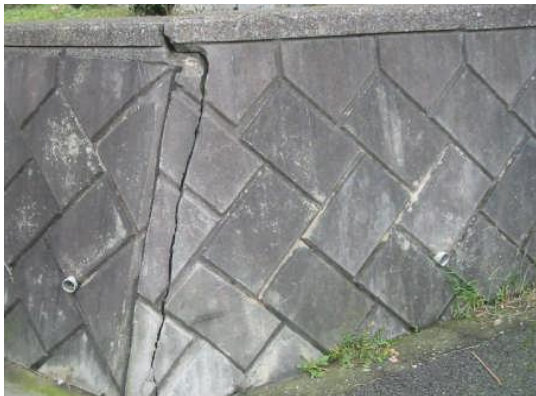
2-② ひび割れ等の部材の劣化、水のしみ出し又は変状
