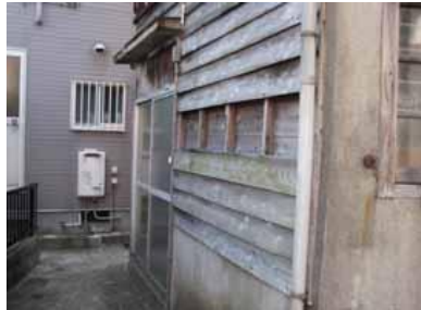
3-(1)-① 剥落又は脱落
