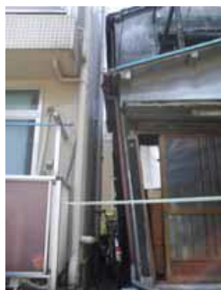
1-(1)-① 建築物の傾斜
