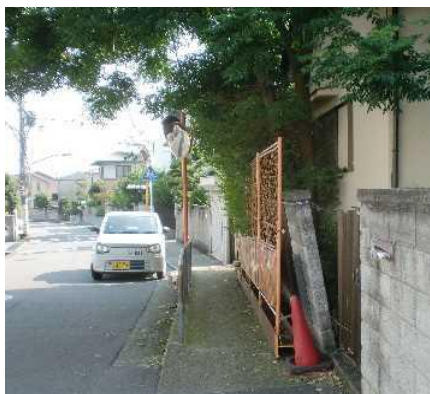
1－(2)－① 門、塀、屋外階段等の傾斜 出典 国土交通省「地方公共団体の空き家対策の取組事例1」
