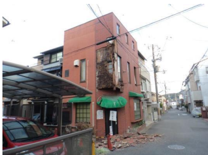
1-(1)-② 屋根全体の変形又は外装材の剥落若しくは脱落 出典 国土交通省「既存不適格建築物に係る指導、助言、勧告、是正命令制度に関するガイドライン」
