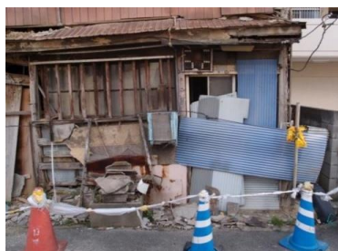
3-(2)-② 突出物の傾き又はこれらの支持部分の破損、腐朽等
