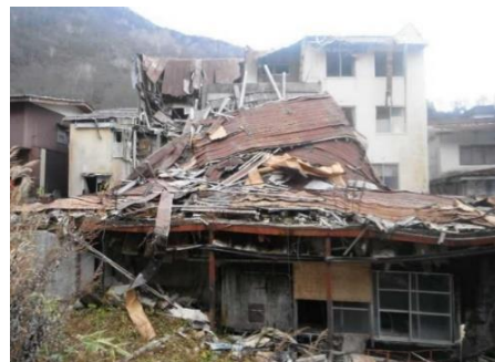
1-(1)-② 屋根全体の変形又は外装材の剥落若しくは脱落
