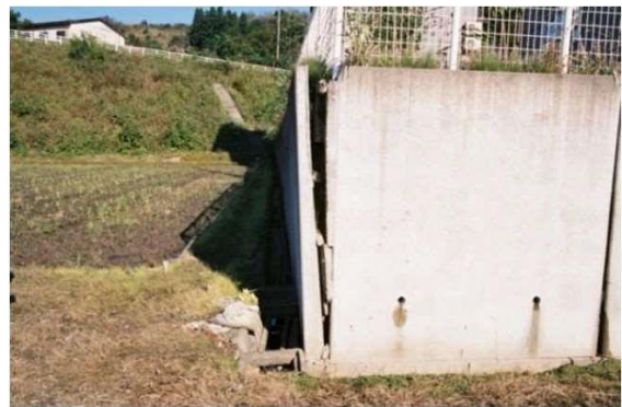
2-② ひび割れ等の部材の劣化、水のしみ出し又は変状
