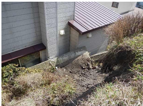
2-① 一部の崩壊又は土砂の流出
