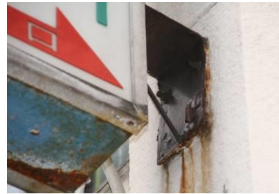
3-(1)-② 破損又はこれらの支持部材の破損、腐朽等
