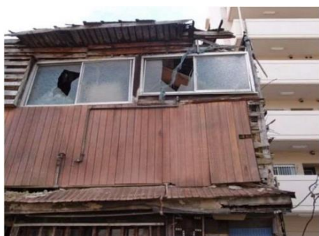
景観を著しく損なっている
