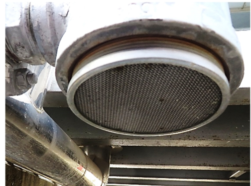
F 5-4 防虫網の破損の確認 (左記写真オーバーフロー管の下部)
