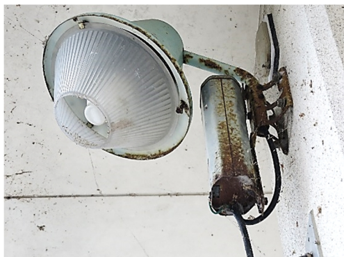
I 1-1 外灯の腐食
