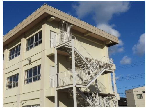
C 6 屋外階段の腐食、ぐらつきの確認
