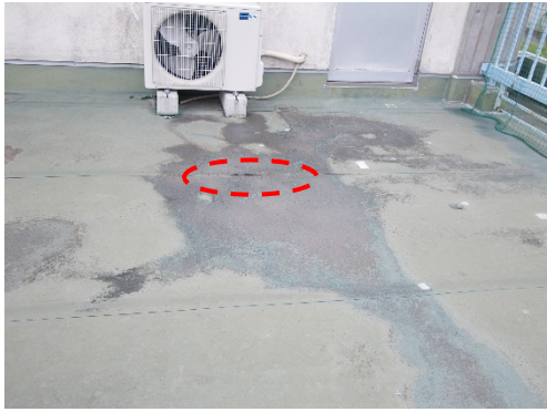
B 1 - 3 屋上防水シートの剥がれ、劣化
