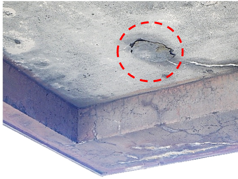
C 3-3 軒裏コンクリートの ひび割れ、落下の危険
