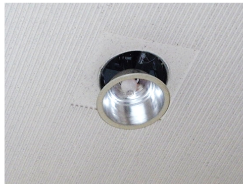
I 1-2 ダウンライトの落下の危険
