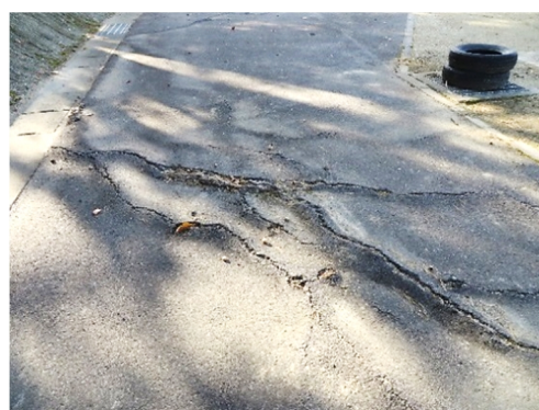
A 3-1 アスファルトの大きなひび割れ
