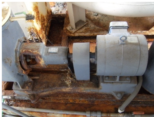
F 6 ポンプの腐食
