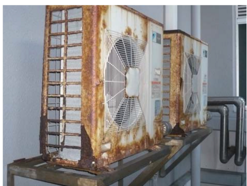
H3 エアコン室外機の腐食
