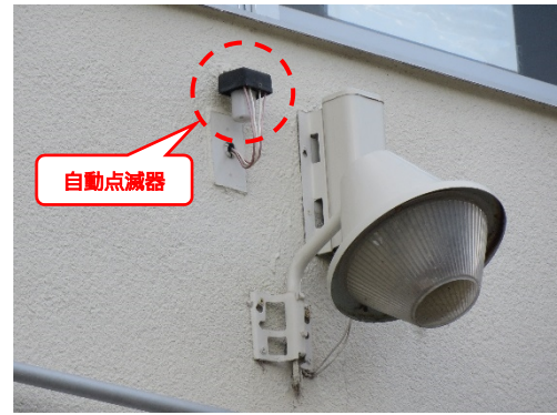
I 3-3 外壁に設置した自動点滅器の例
