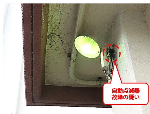
I 3-1 明るいのに点灯している外灯 (自動点滅器故障の疑い)
