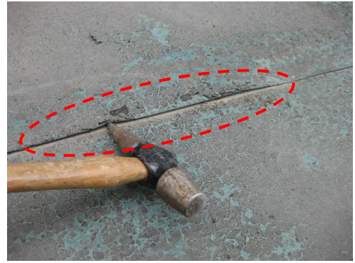
B 1 - 4 左写真点線部アップ (防水シート継目の剥がれ)
