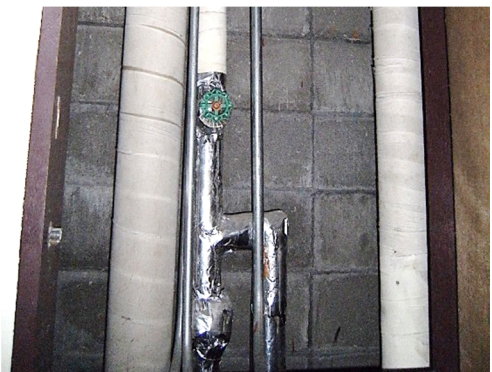
F 2 - 4 左記パイプシャフト内 (可能であれば、配管の水漏れ確認)
