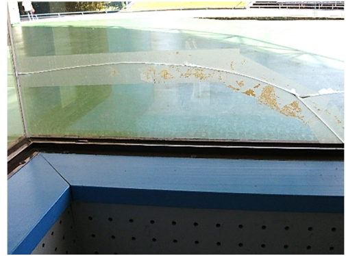
D 2- 4 ガラスのひび割れ
