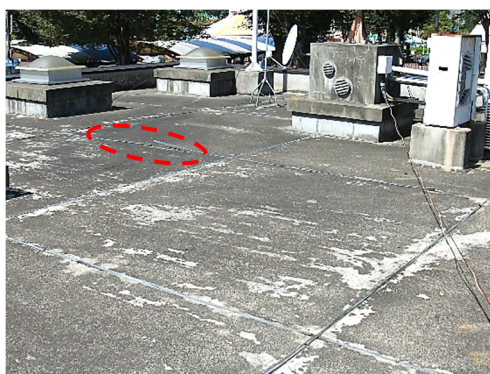
B 1 - 1 屋上コンクリート防水の劣化
