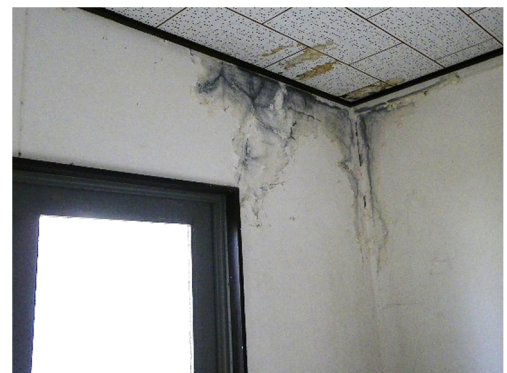
E 4 - 2 雨漏りによる壁面のシミ
