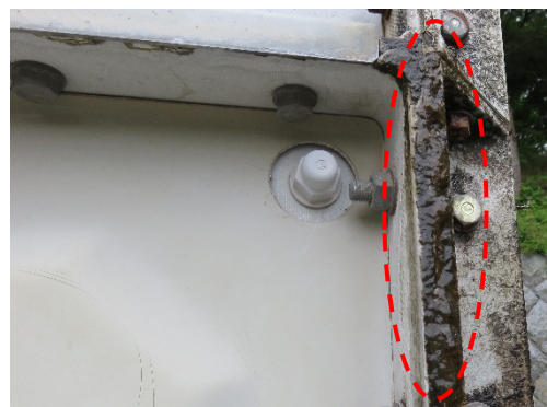
F 5 - 2 受水槽からの水漏れの疑い
