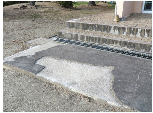
A 3-3 土間のモルタル剥がれ (つまづきの危険)
