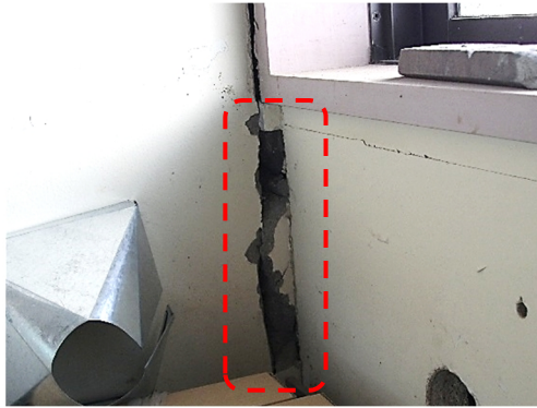
E 2 - 3 壁のひび割れ、破損
