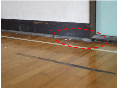
E 1 - 1 床の沈下
