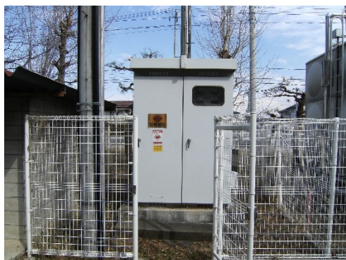
L 1 受変電盤の扉やフェンスの施錠の確認
