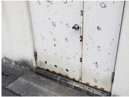
D 2- 3 金属製扉の腐食
