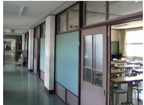
D 1-2 戸の開閉不良やがたつきの確認
