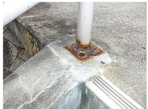
A 5-3 階段手すりの脚の腐食
