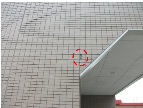
C 2 - 1 外壁タイルの剥がれ、破損
