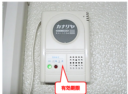
G 2 ガス漏れ警報器の有効期限の確認
