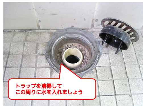
F 1 - 2 トイレ床排水口からの異臭
