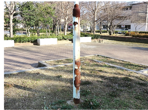
A 5-1 外灯ポールの腐食
