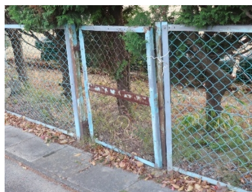
A 2-1 フェンスの腐食、破損
