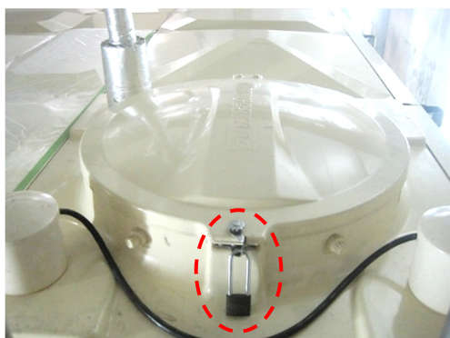
F 5 - 1 受水槽点検口の施錠確認
