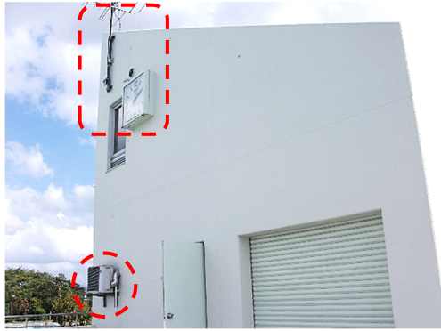
C 5-3 壁面設置物の落下の危険を確認 (手が届く箇所はゆすって、高所は目視で確認)
