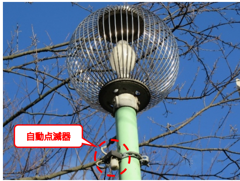
I 3-2 外灯ポールに設置した自動点滅器の例
