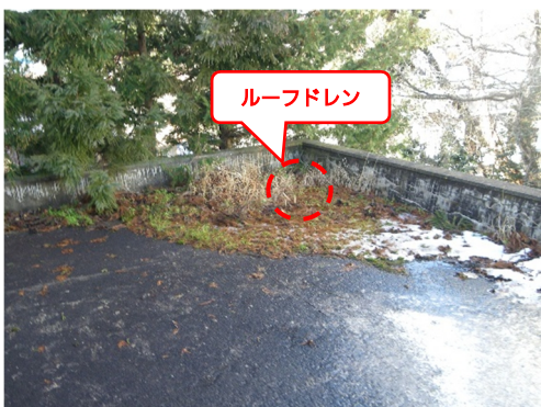
B 3 - 1 ルーフドレン廻りの土・草のつまり
