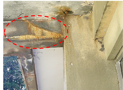
C 3-6 コンクリートの錆汁、白華
