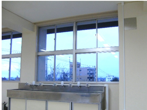
D 1-1 窓のがたつきや落下の危険の確認
