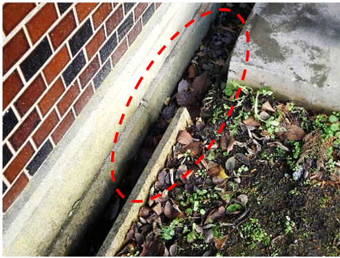
A 4-1 側溝の落葉による排水不良
