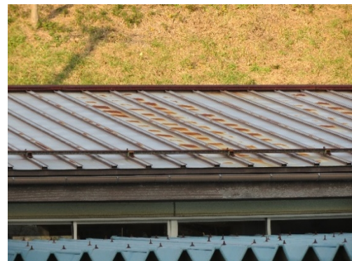
B 1 - 6 トタン屋根の錆
