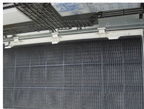
H1-2 左写真フィルターのアップ (きれいな状態)
