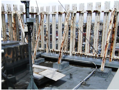
B 4 屋上フェンスの腐食 (特に支柱の根元の腐食に注意)
