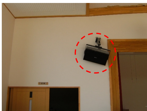
E 6-1 壁面スピーカの脱落
