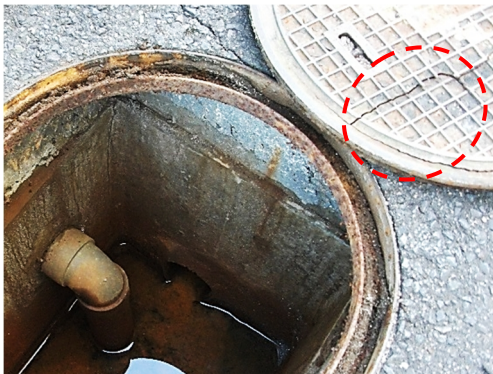
A 4-3 排水樹のふたの割れ
