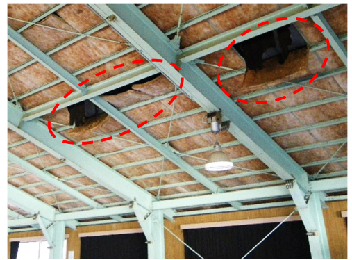
E 3 体育館の天井断熱材の剥がれ
