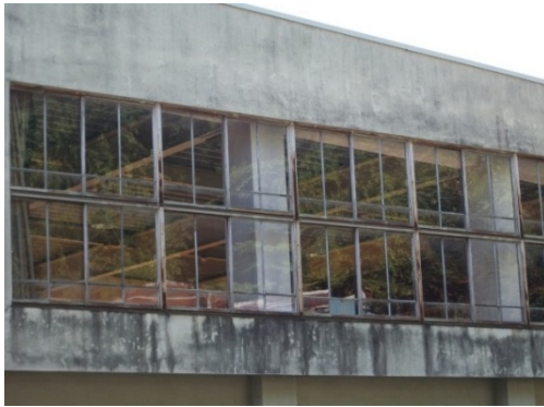
C 1 - 1 外壁塗装の劣化
