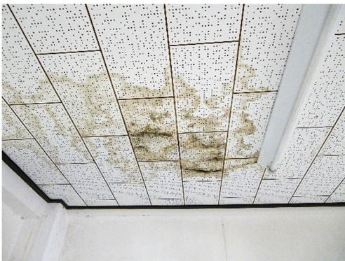
E 4 - 1 雨漏りによる天井面のシミ
