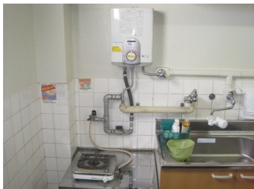
G 1 ガス臭の確認
