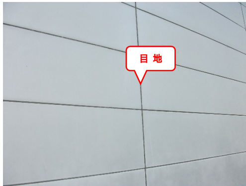
C 4-1 外壁目地シーリングの亀裂、硬化
