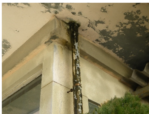
C 5-1 雨樋の腐食
