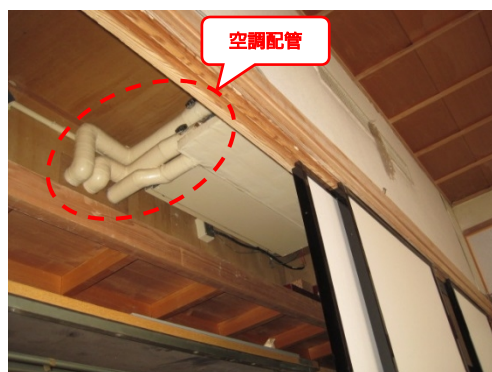
H4 空調配管の水漏れの確認
