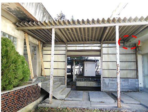
C 3 - 1 軒コンクリートの 破損(爆裂)、鉄筋の露出
