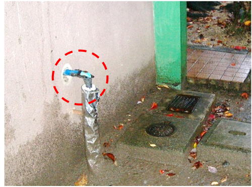
F 2 - 2 給水管保温材の破損 (水道凍結の恐れ)
