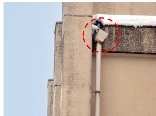
C 5-2 雨樋落下の危険
