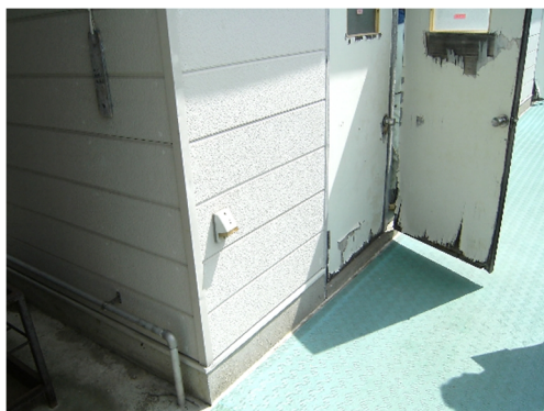
D 2-1 木製扉の腐食
