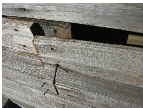
A 2-2 木製柵の破損、くぎの突出
