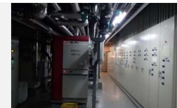
空調設備等機械の老朽化
