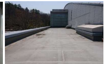
屋根の防水機能の劣化
