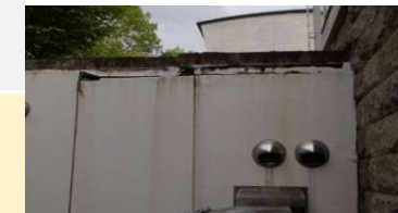
外壁の亀裂・ひび割れ多数
