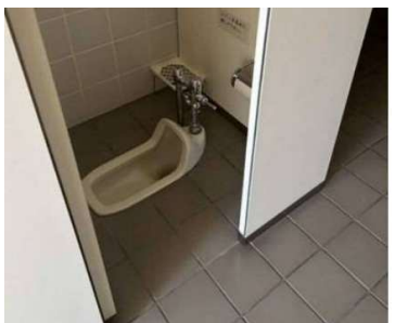
洋式トイレの未整備
