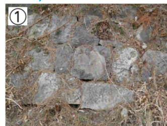
① 貯水池内面石張 明治44年(1911年)近代水道創設時に内面補強
