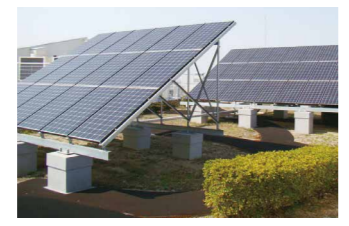
▲屋上に設置された太陽光パネルは、年間約9万キロワットを発電
