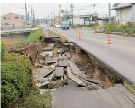
陥没した道路：富久山町(10/14)
