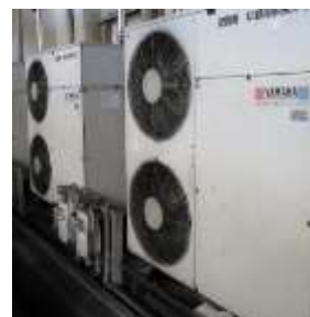
【既存空調・室外機】
