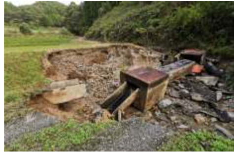
崩落した水田と水路 (中田町高倉)
