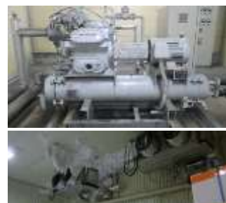
【既存冷凍機・送風機】
