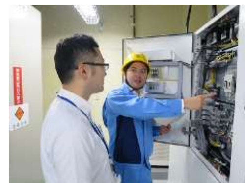
VPP機器設置の様子 （中央公民館）
