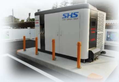
郡山市スマート水素ステーション
