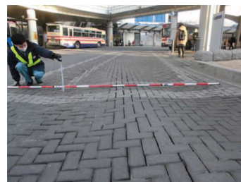
長年の荷重によって沈んだ舗装路面
