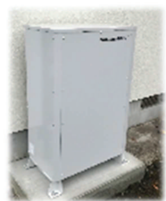
リチウムイオン蓄電池
