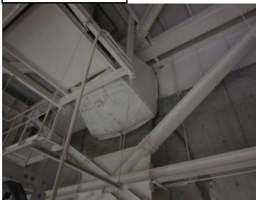
②ダクト破損
