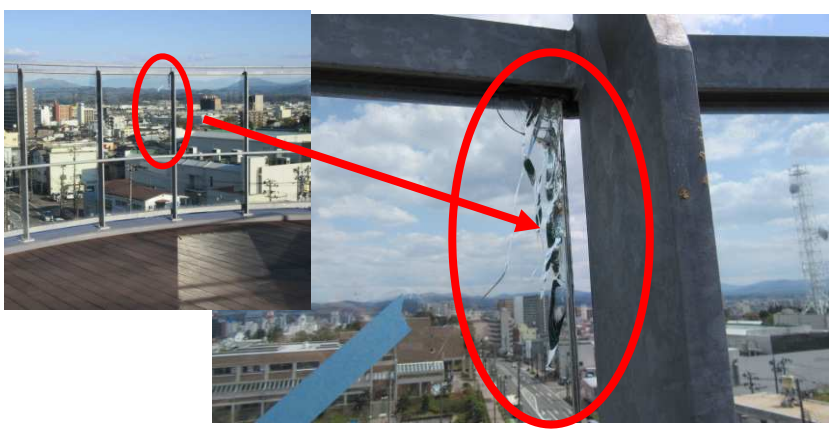
【中央公民館屋上展望台ガラス破損状況】
