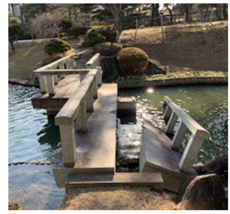
【弁天池橋の被害状況】
