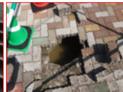
プール通路の陥没
