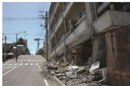
激しい地震により1階部分がつぶれたビル
