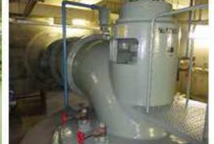
⑤No.1雨水ポンプ
