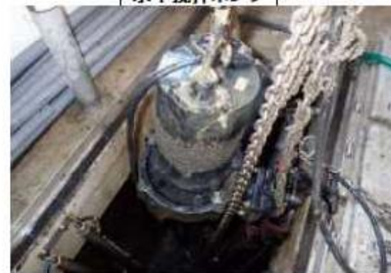
水中攪拌ポンプ
