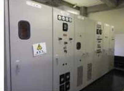
③受変電盤
