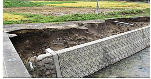
写真④ 上道渡地区 堤防決壊
