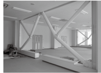
▲地震による揺れを吸収する制震ブレース
