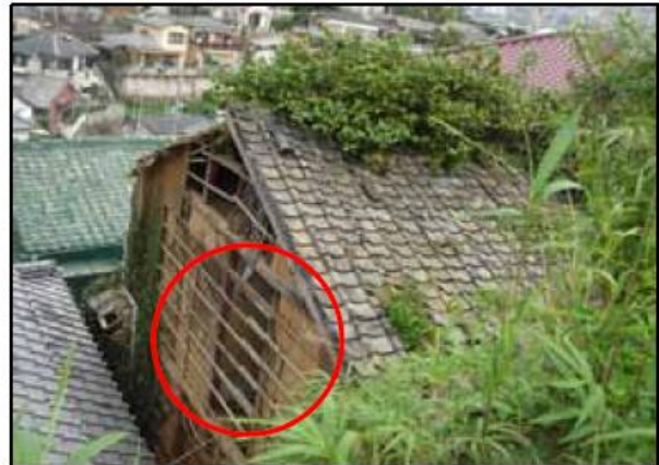
外壁が剥落し、著しく下地が露 出するとともに、壁体を貫通する 穴を生じている例
