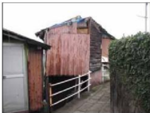
一部の柱が傾斜している例
