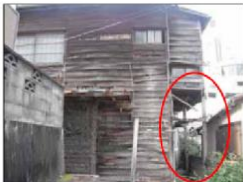
柱の数箇所に破損がある例
