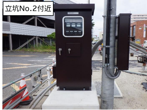
排水ポンプ制御盤設置完了状況
