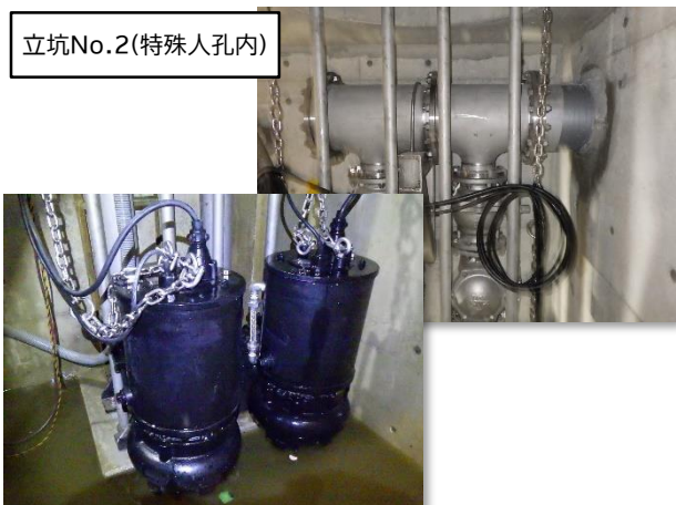
排水ポンプ及び配管設置状況
