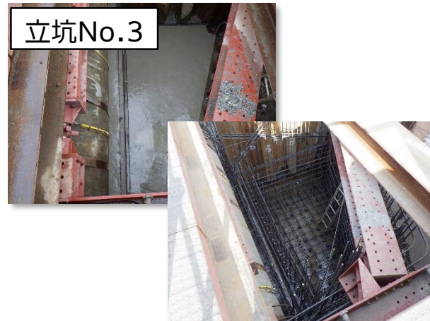
特殊(分水)人孔築造(基礎コンクリート打設、底版配筋)状況
