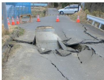
隆起したマンホール
