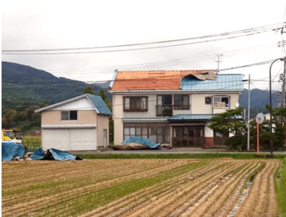
【暴風による猪苗代町内の家屋損壊】
