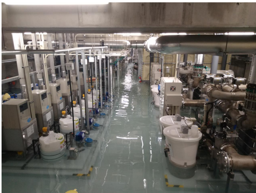
【郡山しんきん開成山プール（地下機械室）： 浸水深2m 】
