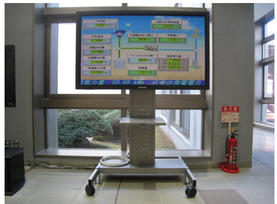
● 市庁舎に導入した太陽光発電設備と発電状況表示モニター
