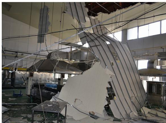
●東日本大震災による被害（中学校給食センター）
