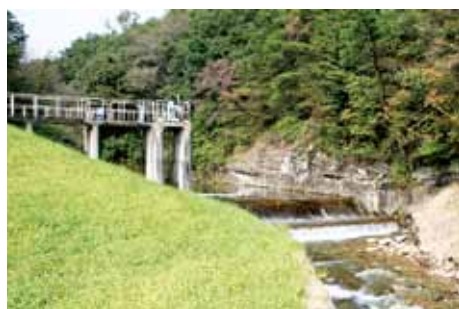
逢瀬川第2取水場 取水量 19,958m 3 /日
