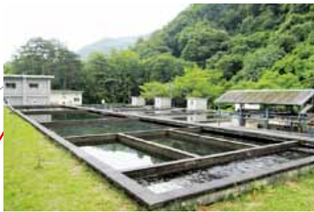
熱海浄水場 施設能力 2,800 m 3 /日
