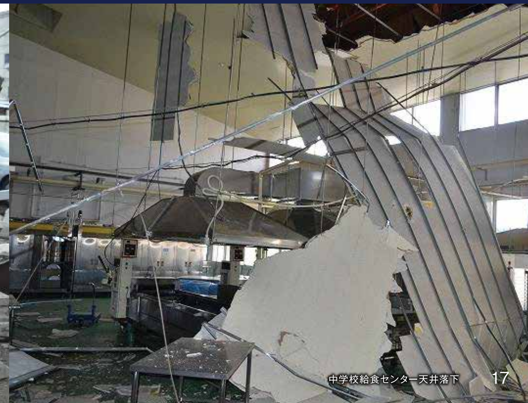
地震によって倒壊した壁
