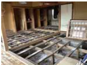
水害で被災した家屋
