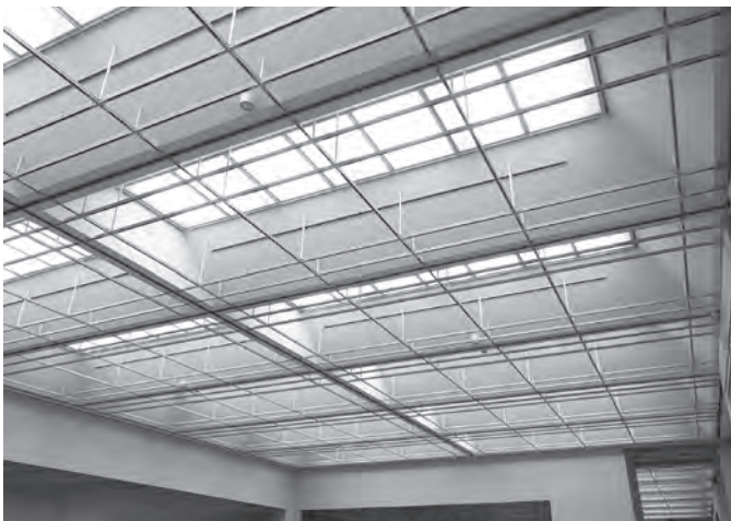
・ライティングダクト設置完成・壁床養生撤去 (3月8日撮影)
