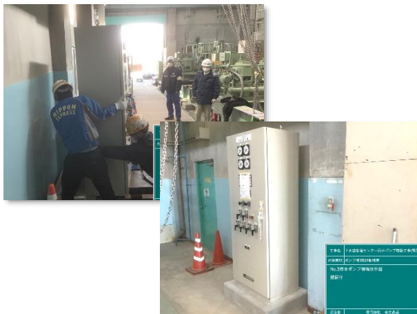
現場操作盤設置状況
