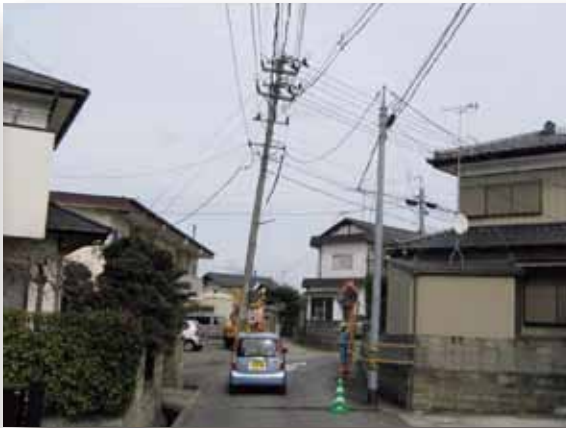
支線抜けによる電柱傾斜
