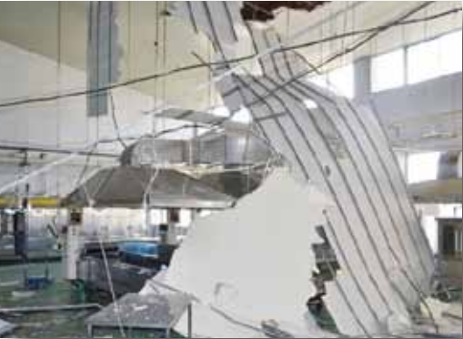
中学校給食センター被災状況
