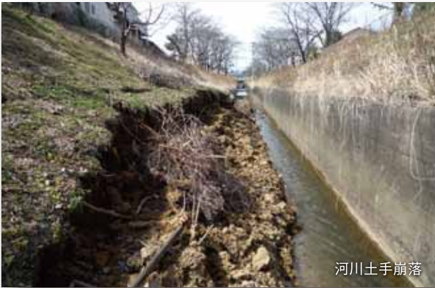
道路・護岸崩落
