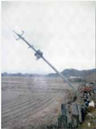
法面崩壊による電柱傾斜
