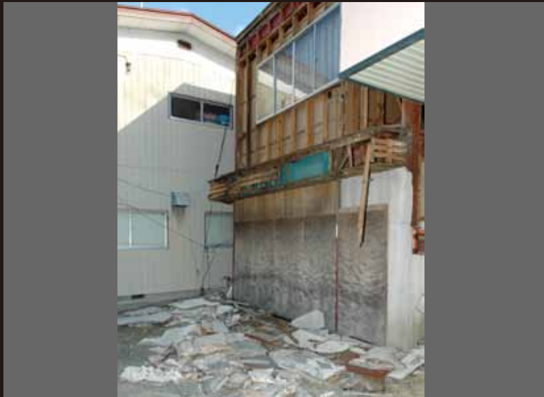
壁などが崩落する建物も多数
