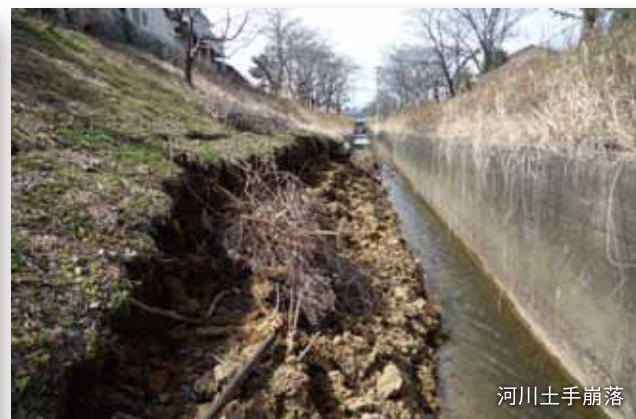
道路・護岸崩落
