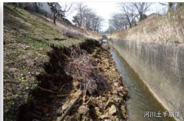
道路・護岸崩落
