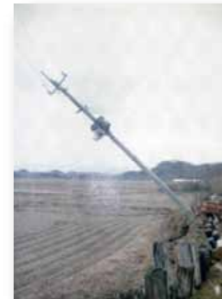
法面崩壊による電柱傾斜
