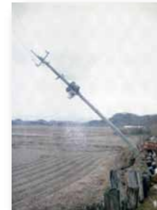
法面崩壊による電柱傾斜
