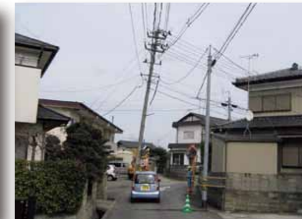
支線抜けによる電柱傾斜
