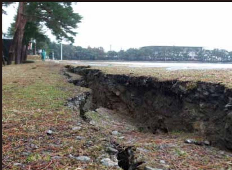
地割れも発生
