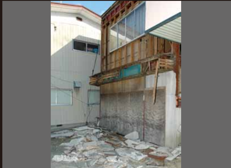
壁などが崩落する建物も多数
