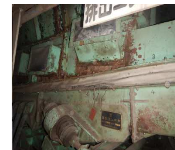
リサイクルプラザコンベア
