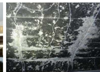
(コンクリートのひび割れ)
