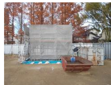
水処理施設（水混じりの除去土壌は凝集剤で砂と水に分離します）
