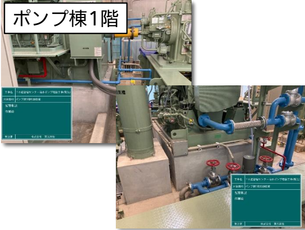
配管・配線(No.3原動機周辺)状況
