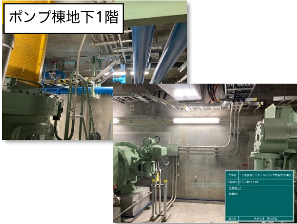
配管・配線(No.3雨水ポンプ・吐出弁周辺)状況
