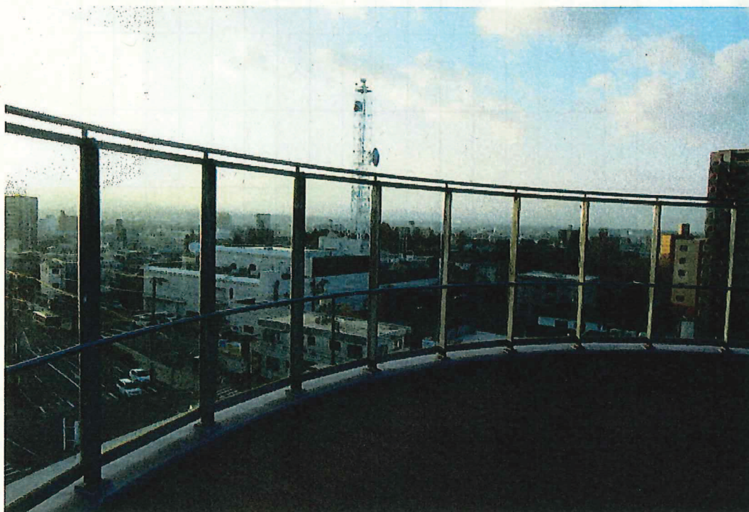
【中央公民館屋上展望台ガラス9枚破損】
