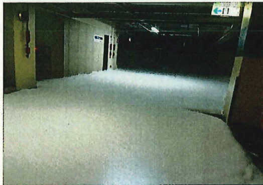
↑3階泡消火剤漏洩(0時20分現在)
