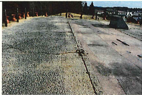
①古墳墳頂部の復元展示施工部亀裂
