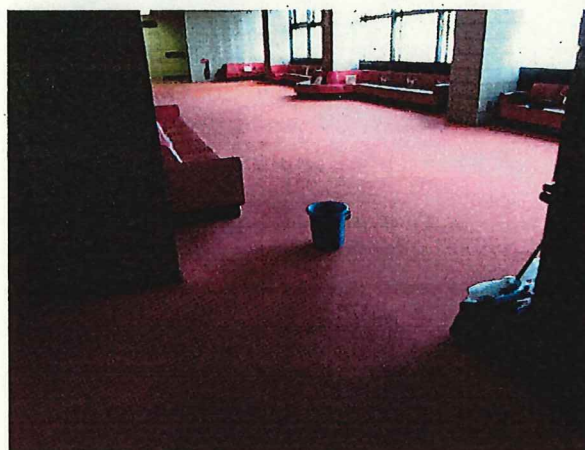
文化センター中ホール ホワイエ水漏れ
