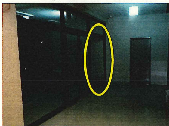
休憩室ガラス破損②
