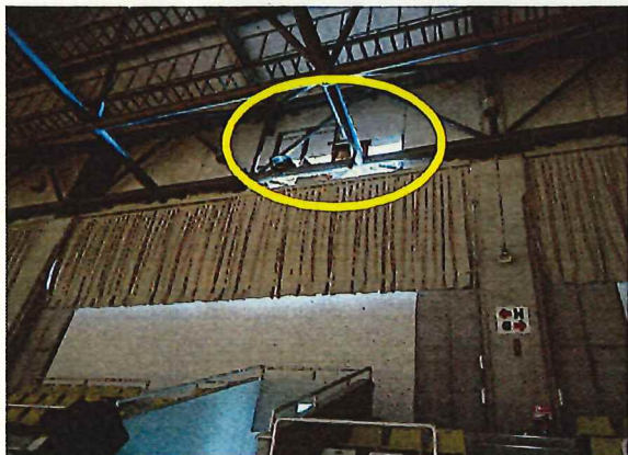
大体育館東側内壁破損
