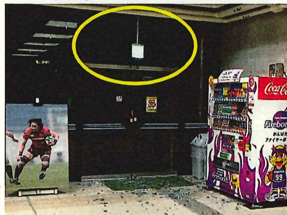
ロビーガラス破損
