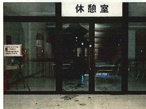
休憩室ガラス破損①
