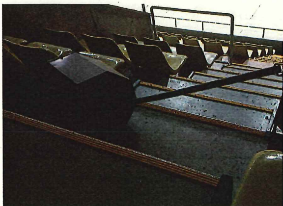
大体育館照明落下
