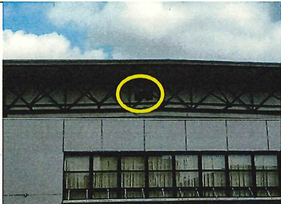
大体育館北側外壁破損
