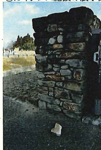
④ガイダンス施設入口門扉のゲート支柱の石(1個)が落下
