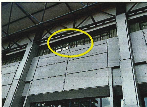
大体育館東側外壁破損
