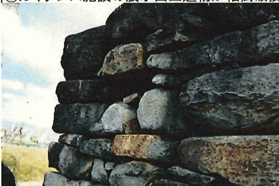
④ガイダンス施設入口門扉のゲート支柱の石(1個)が落下
