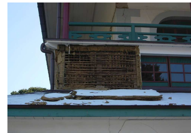
(東日本大震災時の被害)
