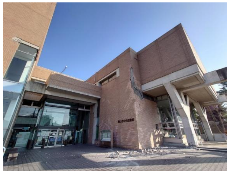
壁が崩れた郡山市中央図書館
